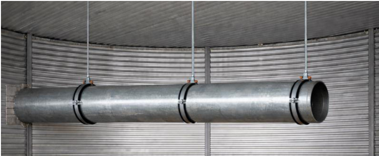
Abbildung 25: Beispielhafte Rohrabhängung der Belüftungsleitung. Dabei spielt es keine Rolle, ob hier Schellen mit oder ohne Gummieinlage verwendet werden.
