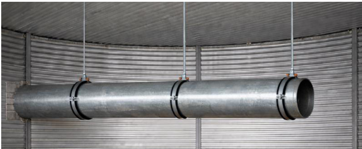
Représentation 25: Exemple de suspension de la conduite de ventilation. Peu importe que l'on utilise ici des colliers avec ou sans insert en caoutchouc
