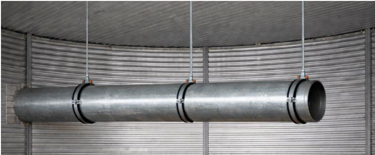
Abbildung 25: Beispielhafte Rohrabhangung der Belufungsleitung. Dabei spielt es keine Rolle, ob hier Schellen mit oder ohne Gummieinlage verwendet werden.
