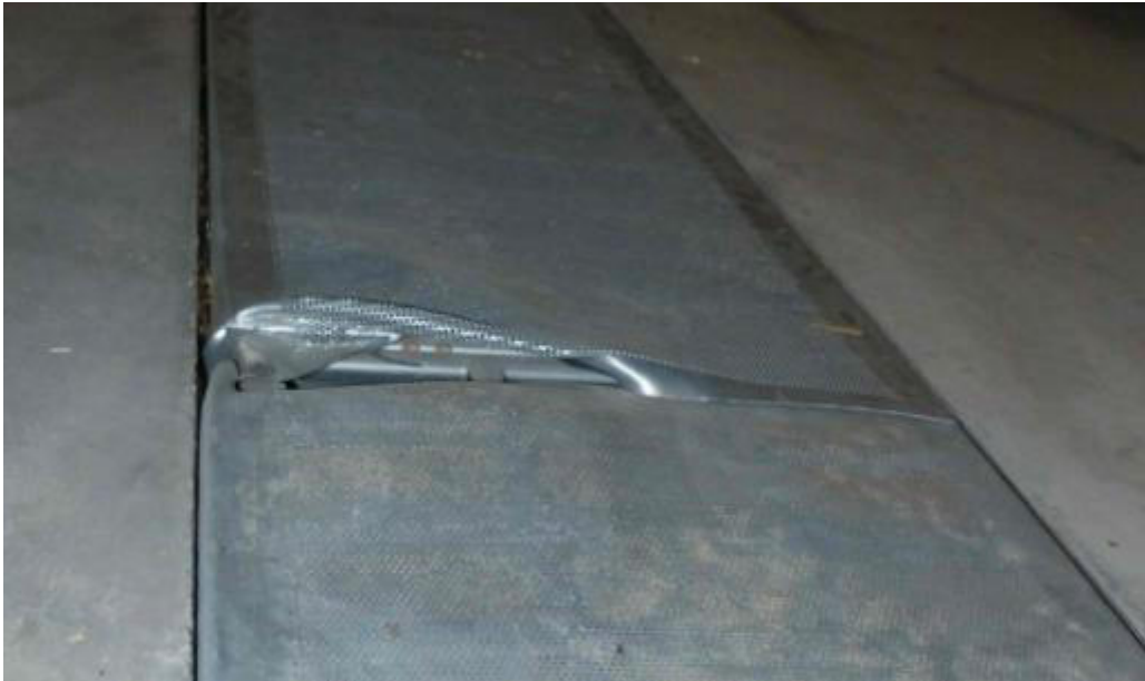
Abbildung 6: Beschädigtes Element durch falsches Auslegen der Abdeckungen
