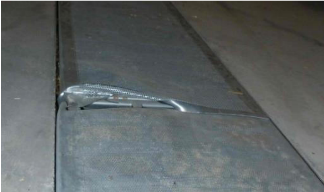
Рисунок 6: Повреждённый элемент из-за неправильной установки покрытий
