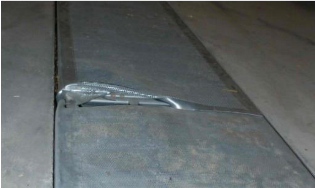
Représentation 6: Élément endommagé à cause d'une mauvaise disposition des grilles
