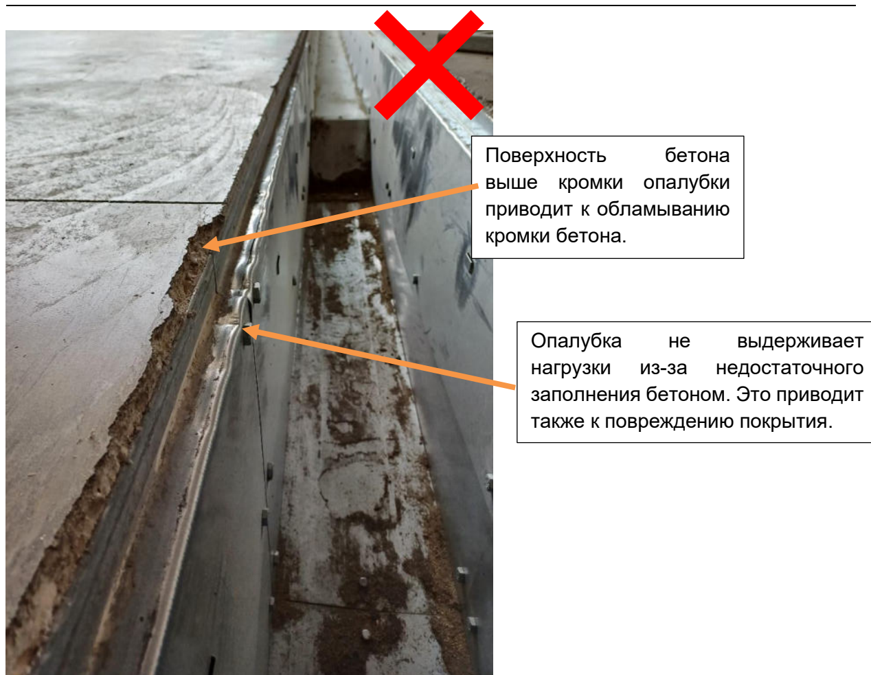
Рисунок 8: Пример последствий неправильного бетонирования
