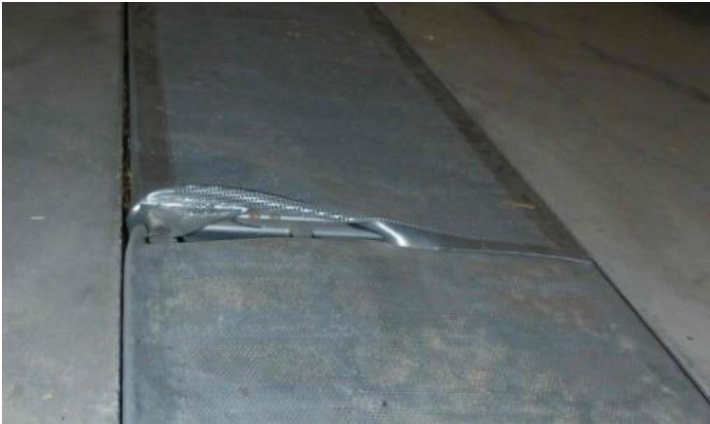
Abbildung 11: Beschädigte Lochblechabdeckung durch falsches Auslegen der Abdeckungen
