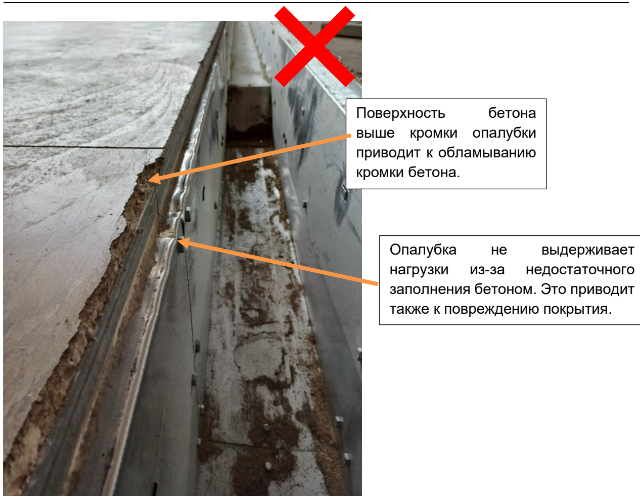
Рисунок 8: Пример последствий неправильного бетонирования
