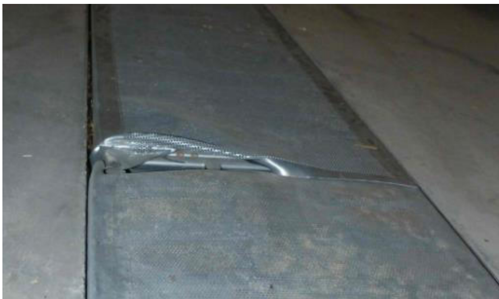
Représentation 11: Élément endommagé en raison d'une mauvaise mise en place des grilles
