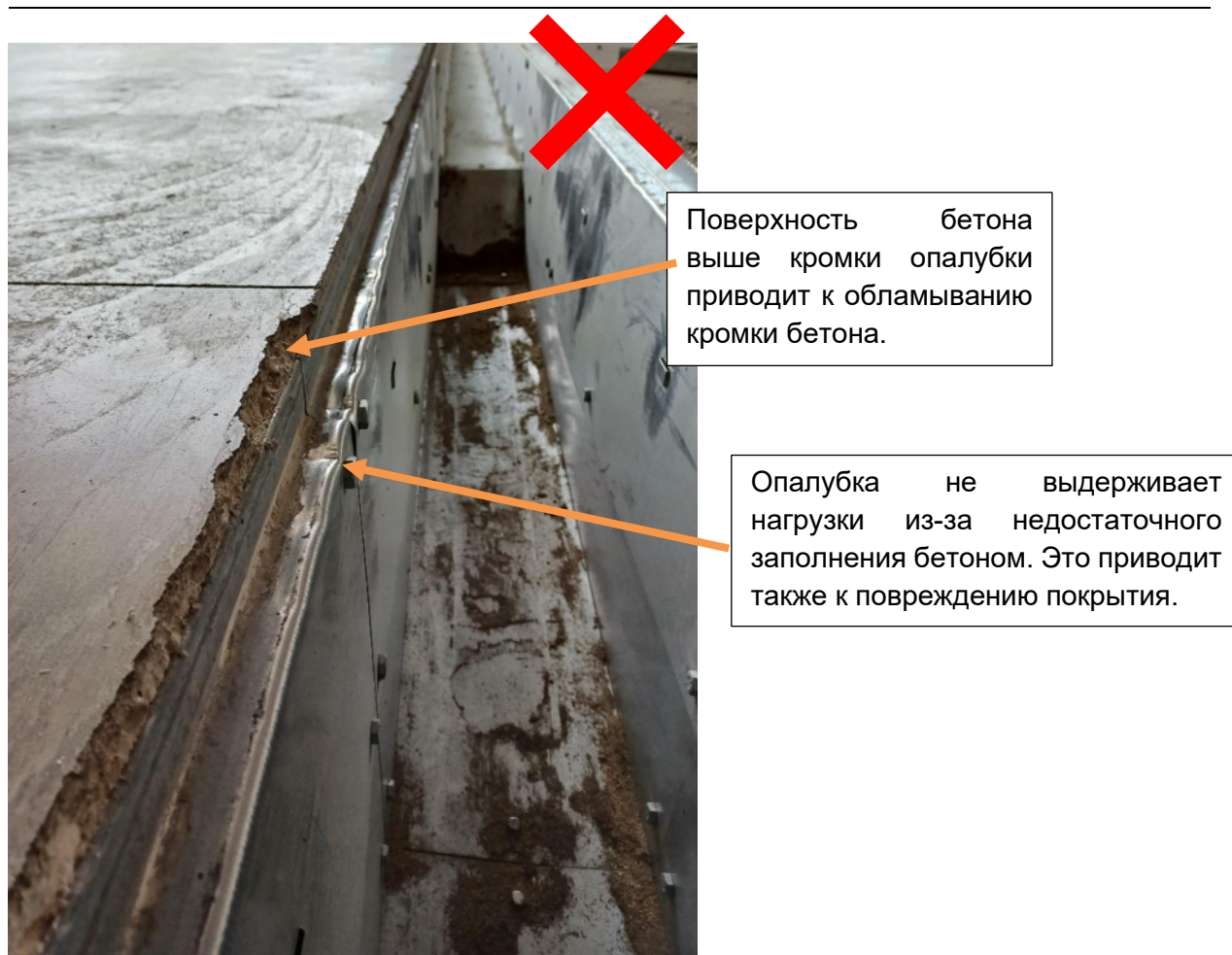
Рисунок 8: Пример последствий неправильного бетонирования
