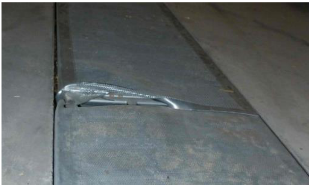
Рисунок 11: Повреждённый элемент из-за неправильной установки покрытий
