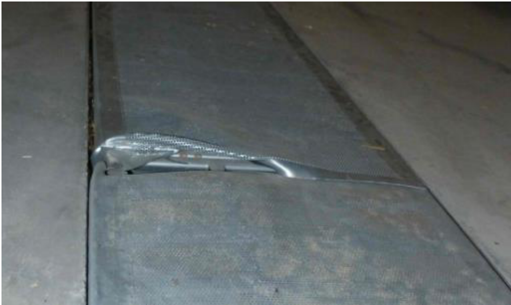
Abbildung 11: Beschädigtes Element durch falsches Auslegen der Abdeckungen
